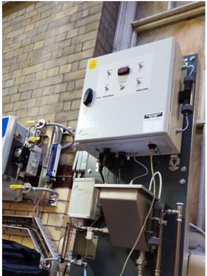
Zahl 18 - MS1200 wurde 2014 installiert
