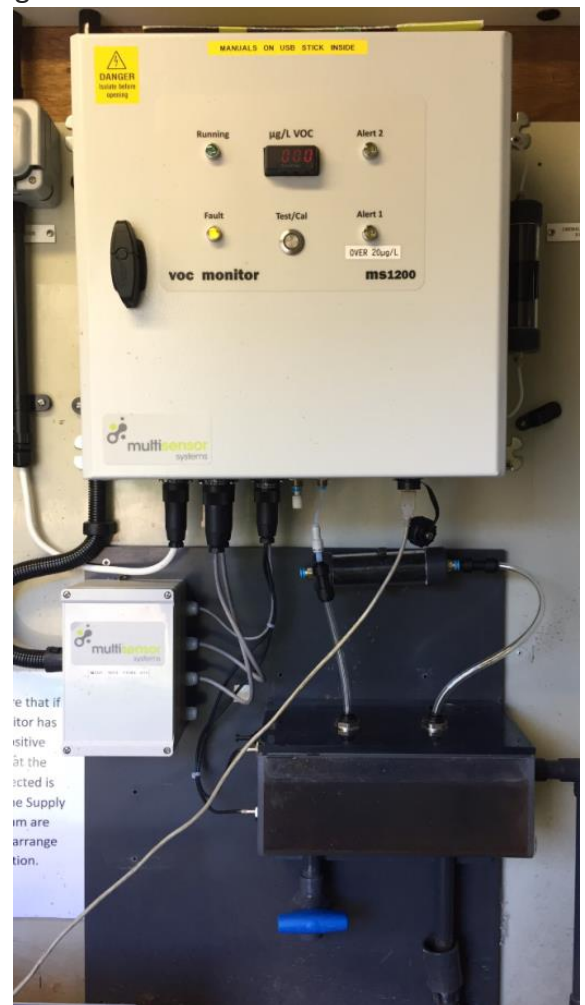
Zahl 16- Ein Bild der im Nebengebäude installierten Einheit. Das Gerät steuert ein Schleusentor, das bei Verschmutzung den Durchfluss vom Vorratsbehälter wegleitet
